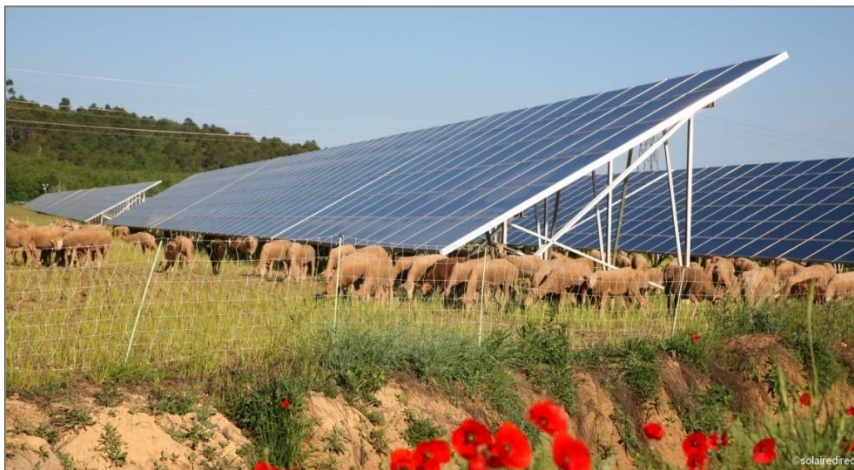
Pacage ovin sur le parc solaire de Vinon-sur-Verdon - 83 (Source : Solaire direct)
