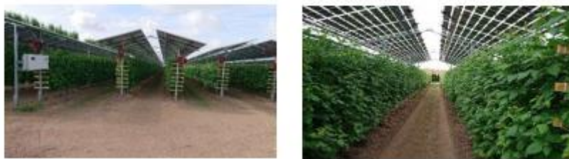
Photographie 1 : Plantations de framboisiers sous structures photovoltaïques (Source : Schindele et de Vries, 2020)
