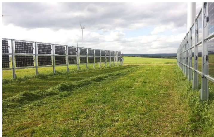
Photographie 3 : Installation photovoltaïque au sol avec des panneaux verticaux (Next2Sun)
